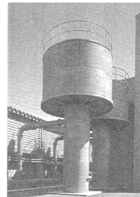
Uチューブオゾン接触設備
